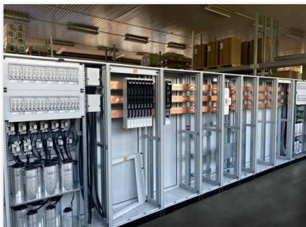
Proces tovarniške montaže nizkonapetostnih stikalnih blokov. Stikalni blok s sklopom kondenzatorjev in zaščitnih odklopnikov.
