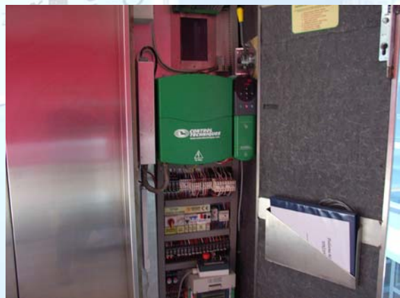
Osebno dvigalo z elektronskim regulatorjem v najvišjem nadstropju zgradbe.
