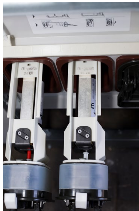
Povezave v notranji stikalni napravi, primer:
